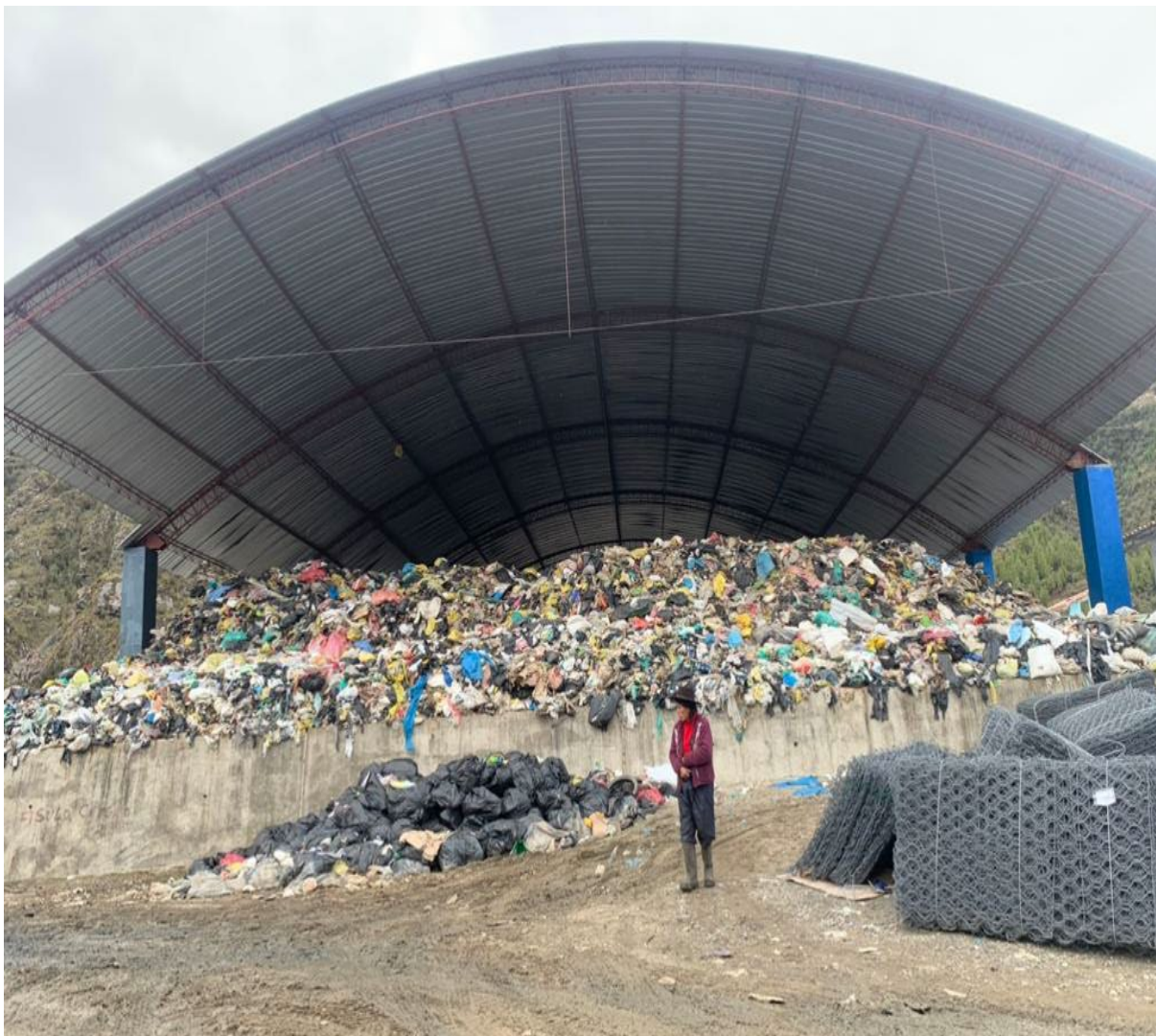
Botadero del distrito de San Marcos colapsado. Se ubica en el paraje Chuchus del caserío de Manyampampa, Centro Poblado de Carhuayoc.
